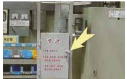
크레인 점검통로 입구 잠금장치
